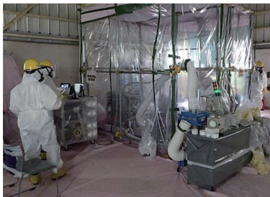
図 20 東電 HD との共同研究で実施した 66kV 開閉所での試験
