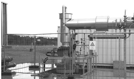
〔深度3,446m生産井〕
