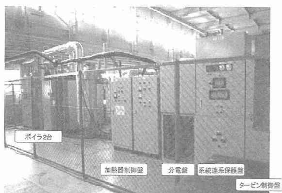
図12 神鋼神戸総合技術研究所内発電所
