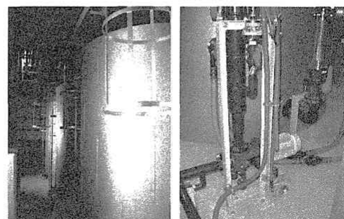
(c) RF電解液タンク (d) RF電解液ポンプ
