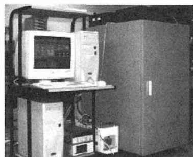
図2 電力貯蔵システムの外観 (2)
